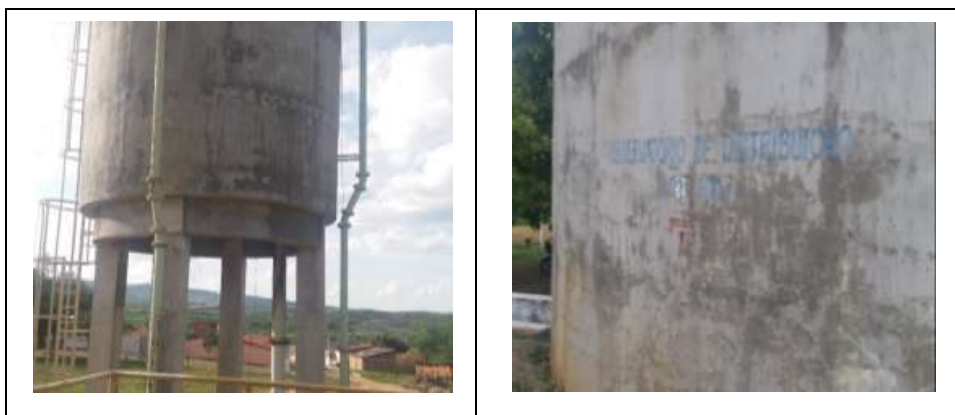
Figura 33 – Estrutura de Reservação do SAA da Embasa.
