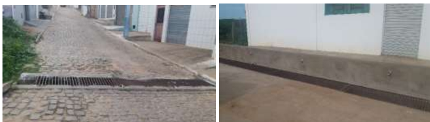
Figura 43 – (A) e (B): Dispositivos de drenagem na sede municipal de Tremedal
