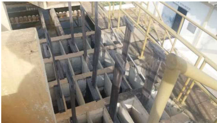
Figura 32 – ETA do SAA da Embasa.
