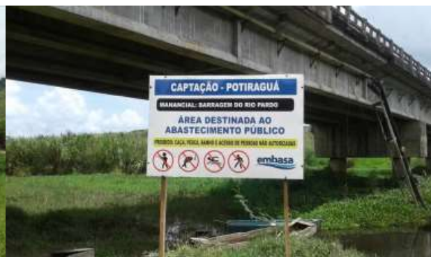
Foto 09 – Captação rio Pardo
