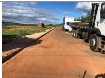
Foto 5 – Estaca 0, sentido estaca 03. Observação foi feito correção de fissuras e surgimentos de fissuras.
