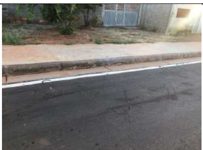
FOTO 12 – Estaca 1 sentido estaca 0 ( vista). Observação para afundamento da via e surgimento de novas fissuras.
