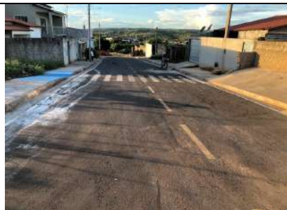
FOTO 10 – Estaca 5 sentido estaca 0 (vista). Observação para correções de fissuras e surgimento de novas fissuras.
