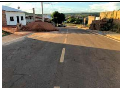
FOTO 9 – Estaca 3, sentido estaca 0 (vista). Observação para fissuras.
