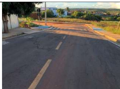
Foto 8 – Estaca 1, sentido estaca 0(vista). Observação foi feito correção de fissuras e surgimentos de fissuras.
