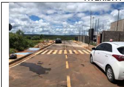
FOTO 25 – Estaca 0 sentido estaca 4. Observação para surgimento de novas
