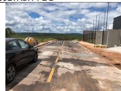
OTO 26 – Estaca 1 sentido estaca 04. Observação para correções de fissuras e
