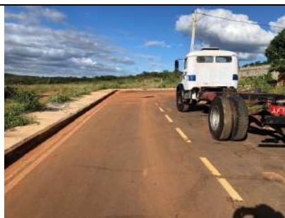
Foto 6 – Estaca 02, sentido estaca 03. Observação foi feito correção de fissuras e surgimentos de fissuras.
