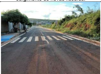
FOTO 16 – Estaca 6 sentido estaca 0 ( vista). Observação para correções de fissuras e surgimento de novas fissuras.
