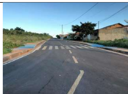
FOTO 11 – Estaca 0 sentido estaca 6. Observação para correções de fissuras e surgimento de novas fissuras.
