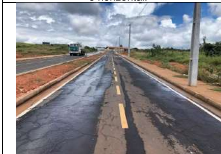
FOTO 23 – Estaca 1 sentido estaca 8. Observação para correções de fissuras e surgimento de novas fissuras.
