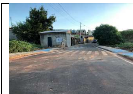
Foto 13 – Estaca 0, sentido estaca 3. Serviço de pavimentação asfáltica, passeio, rampas, sarjeta, meio fio, sinalização vertical e horizontal.
