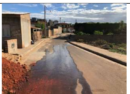
FOTO 14 – Estaca 01 sentido estaca 03. Observação para correções de fissuras.
