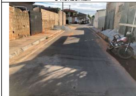
FOTO 19 – Estaca 02 sentido estaca 03. Observação para correções de fissuras e surgimento de novas fissuras.
