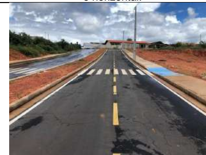
FOTO 24 – Estaca 5 sentido estaca 8. Observação para correções de fissuras e surgimento de novas fissuras.
