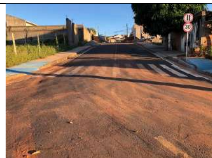
Foto 7 – Estaca 0, sentido estaca 5. Serviço de pavimentação asfáltica, passeio, rampas, sarjeta, meio fio, sinalização vertical e horizontal. Observação para afundamento da via.
