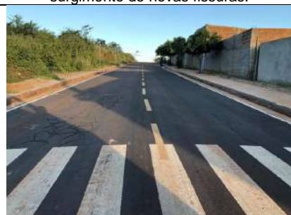
FOTO 15 – Estaca 4 sentido estaca 6. Observação para correções de fissuras.
