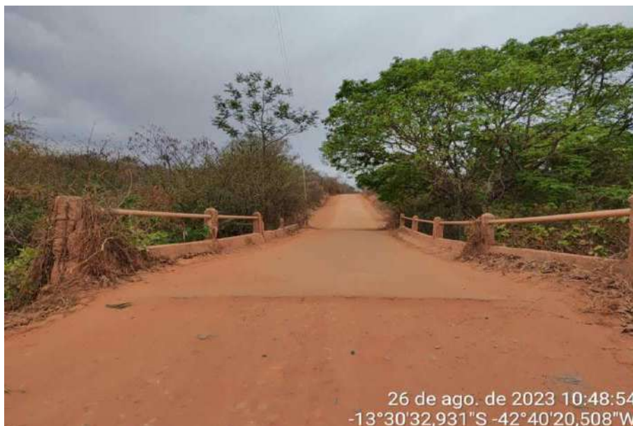
Flecha da laje
