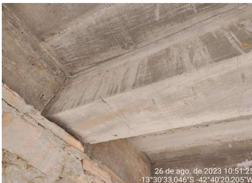
Viga que apresenta fissuras
