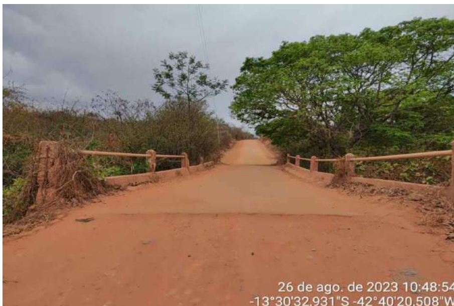
Flecha da laje
