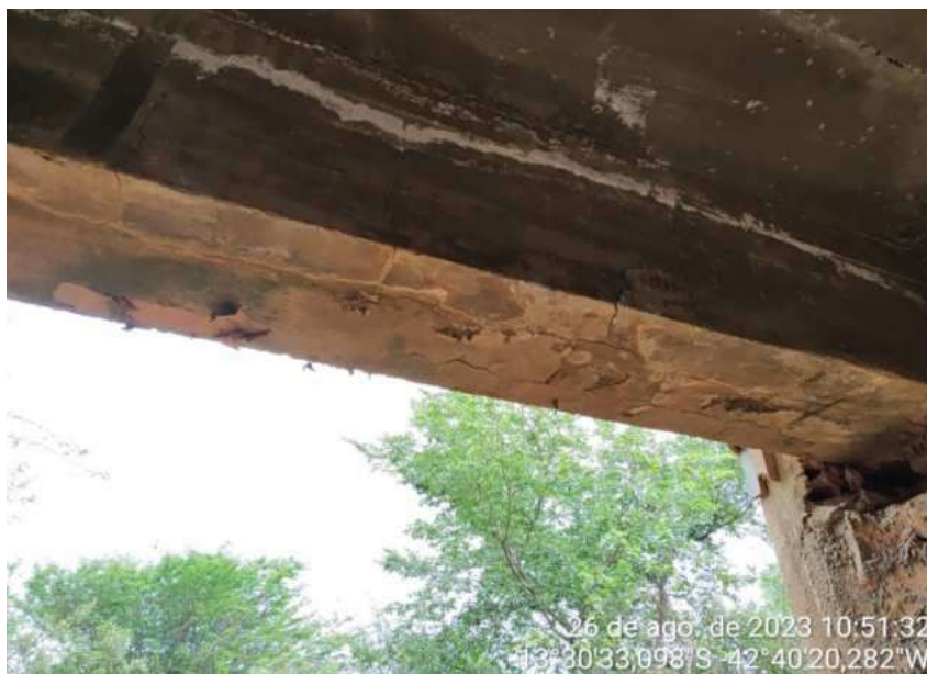
Viga que apresenta fissuras
