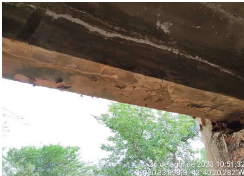
Viga que apresenta fissuras
