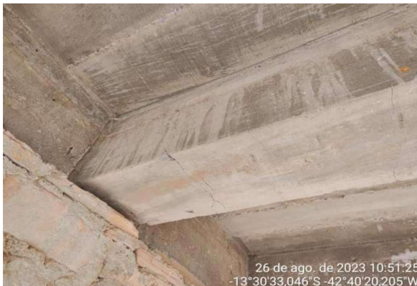
Viga que apresenta fissuras
