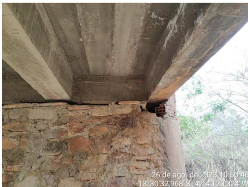
Tabuleiro sem apoio correto nos pilares
