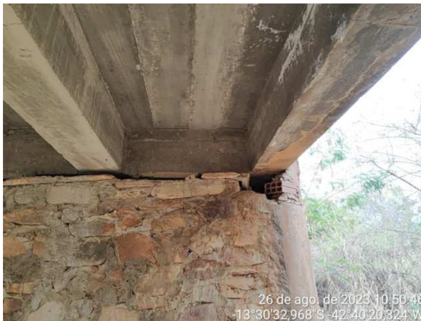
Tabuleiro sem apoio correto nos pilares
